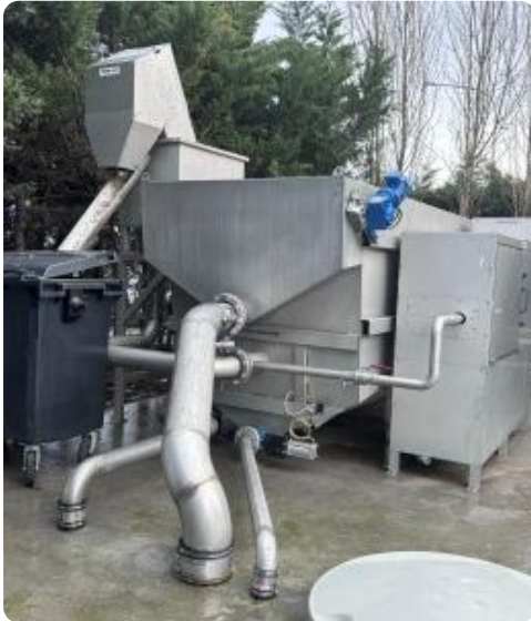
Afbeelding: het afvalwaterzuiveringssysteem dat op de locatie van Viangro is geïnstalleerd
