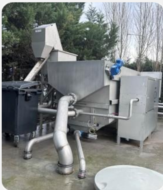
L'image ci-dessus illustre le système de traitement des eaux usées installé sur le site de Viangro
