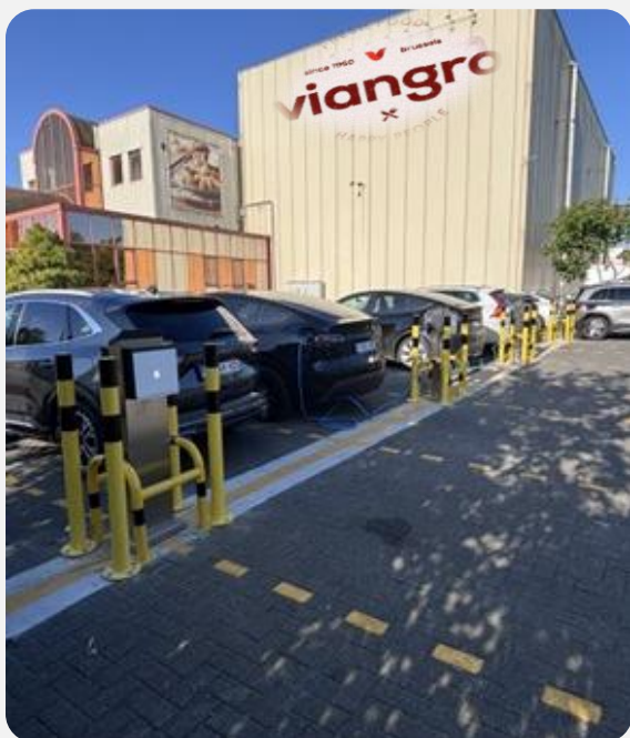
L'image ci-dessus illustre les bornes de recharge déjà installées sur le site de Viangro
